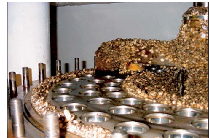
Geöffnetes Filtergehäuse mit Siebeinsatz und darauf gleitendem Spülarm – volle Funktionsfähigkeit trotz Muschelbewuchs.
